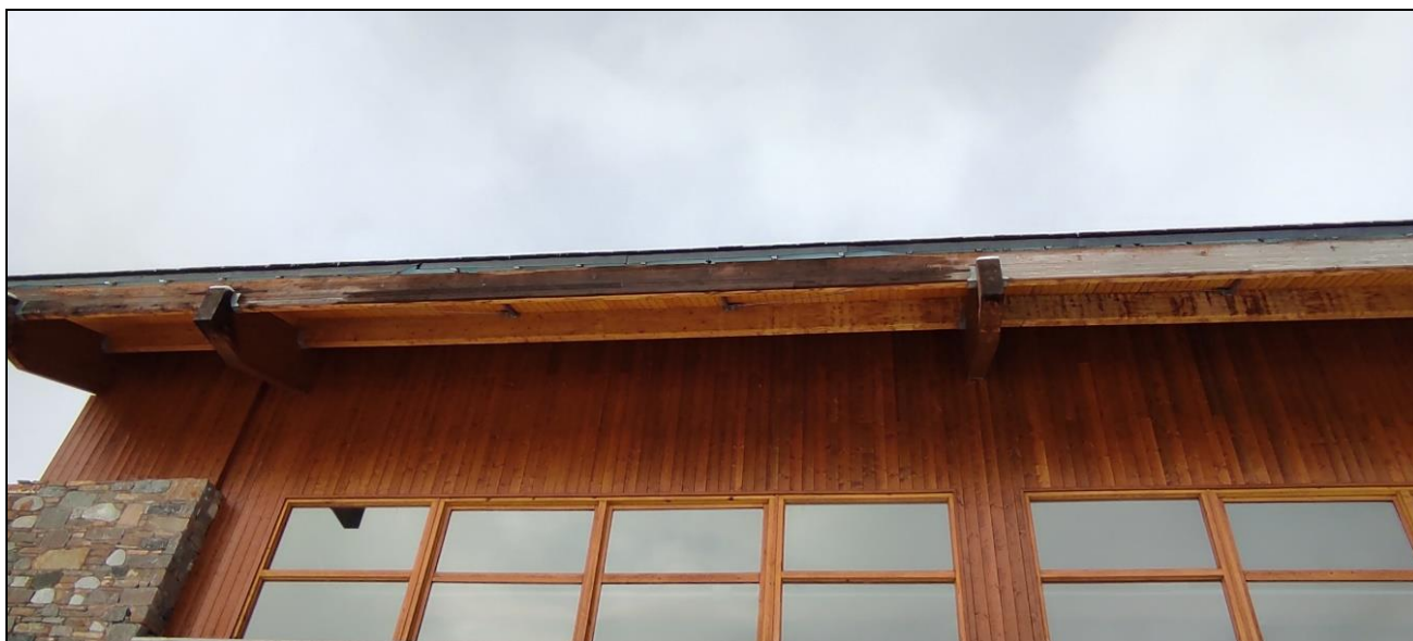
Imágenes en las que se muestra la inexistencia de canaleras y el deterioro que se está produciendo en la madera a causa de la acumulación de agua
